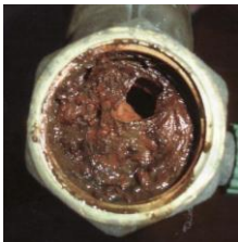
Eine rund 20 Jahre alte Wasserleitung. Hier besteht unbedingt Handlungsbedarf!
